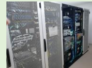
SINET拠点設備の管理・運用
