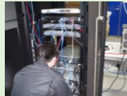
研究科の通信設備の構築
