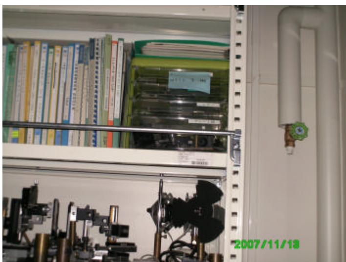
図2. 巡視指摘事項の改善事例集から（落下防止措置）
