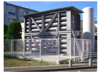
ヘリウムガス回収カードル
