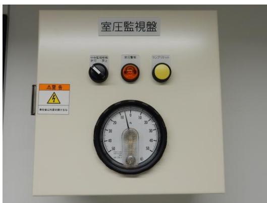
写真6. 実験室差圧監視盤
