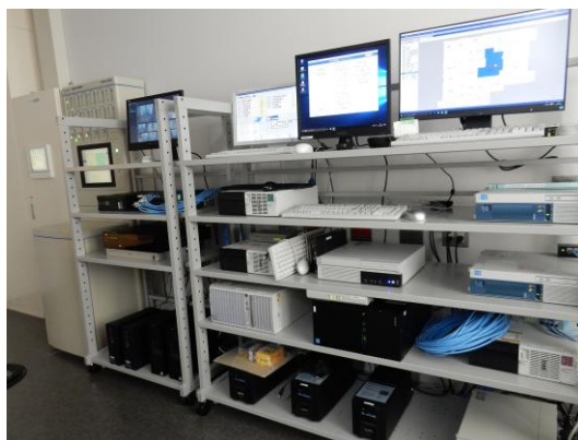
写真5. 制御サーバ群
