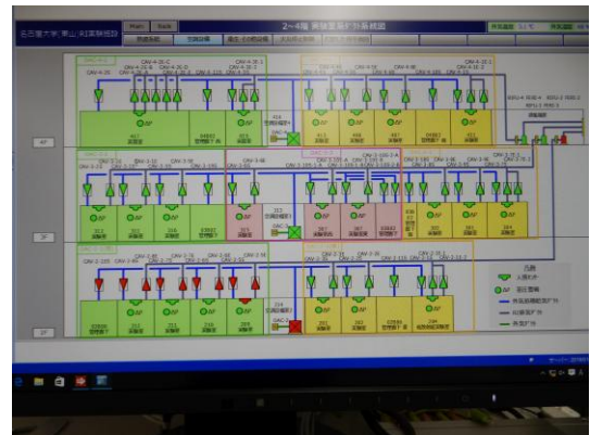
写真3. 空調制御システム制御画面
